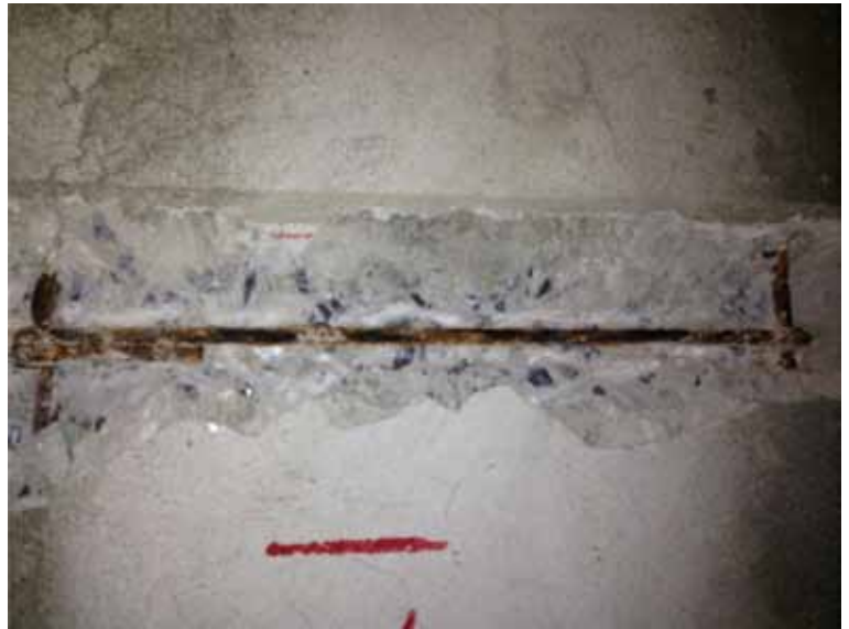
Şekil 5 - Kolonda beton kabuğun (paspayı) sıyrılması (tahribatlı yöntem)
