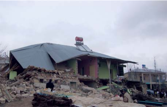
Şekil 9 - Okçular köyündeki tamamen yıkık durumda olan yığma bir bina ile hemen yanında hasarsız bir betonarme yapı
