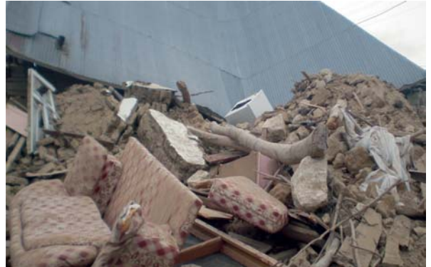
Şekil 10 - Okçular köyündeki tamamen yıkık durumda olan yığma yapı
