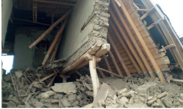
Şekil 6 - Tabanözü köyündeki hasar görmüş kerpiç yapı
